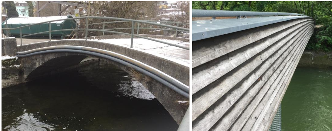
Abb. 8: Ansicht links: Brücke über den Amperkanal nördlich der Aumühle; Ansicht rechts: Seitenansicht der Brücke südlich des Wasserkraftwerks
